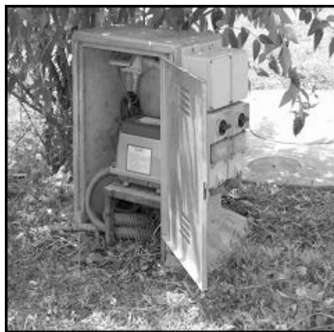
ESEMPIO DI LOCALE TECNICO
